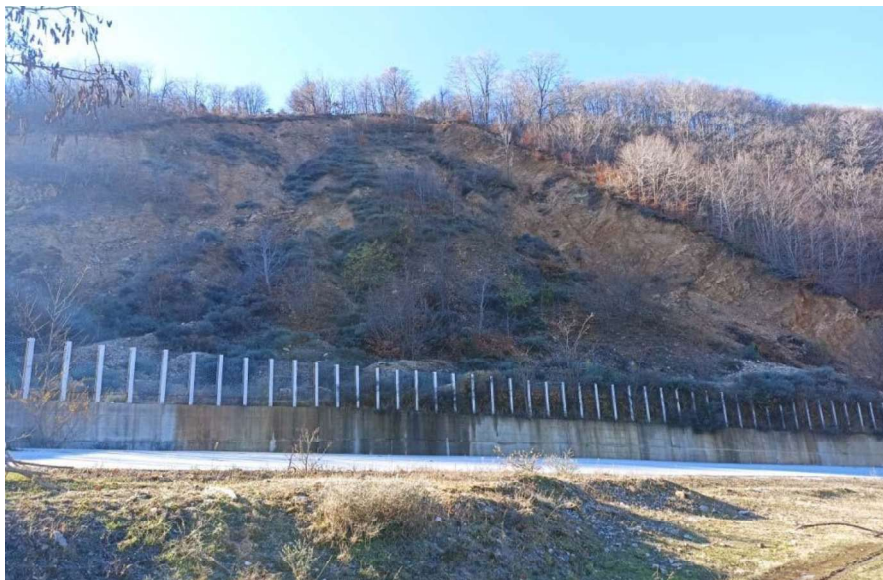
Εικόνα 1: Αντιστήριξη πρανούς - Κατολίσθηση
